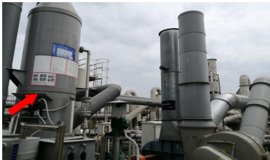
绿漆前处理酸性废气碱性喷淋处理设施
