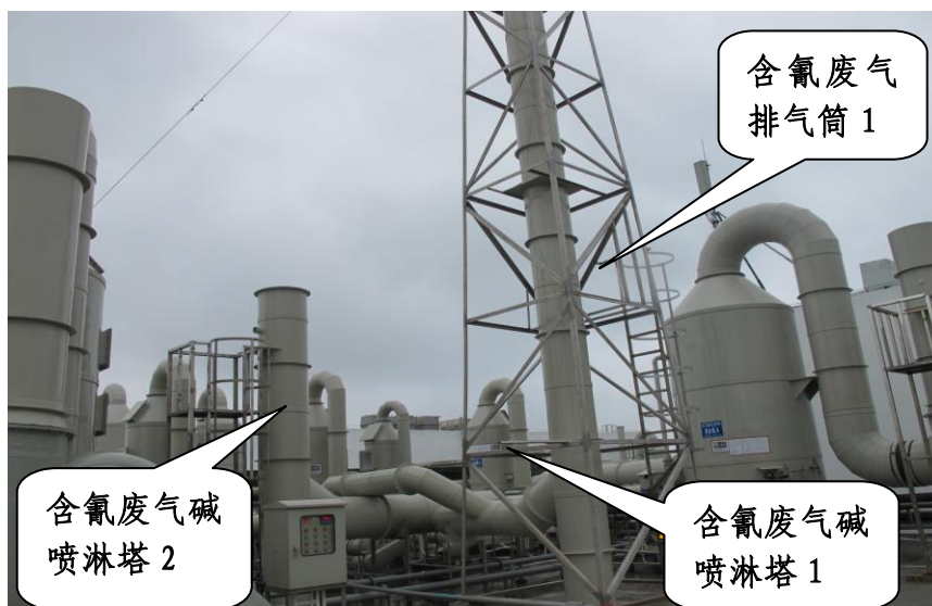
浸金+镀镍退镀含氟废气处理系统及排气筒
