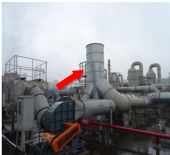
2-1# 有机废气排气筒
