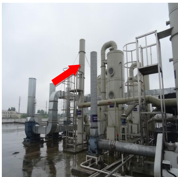
2-2# 有机废气排气筒(OD+M6)
