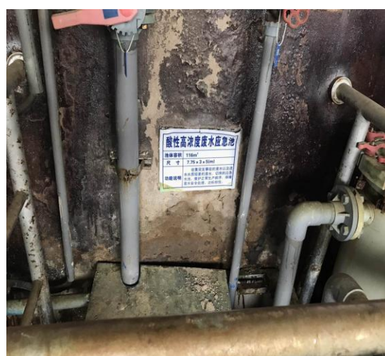
酸性高浓度废水应急池
