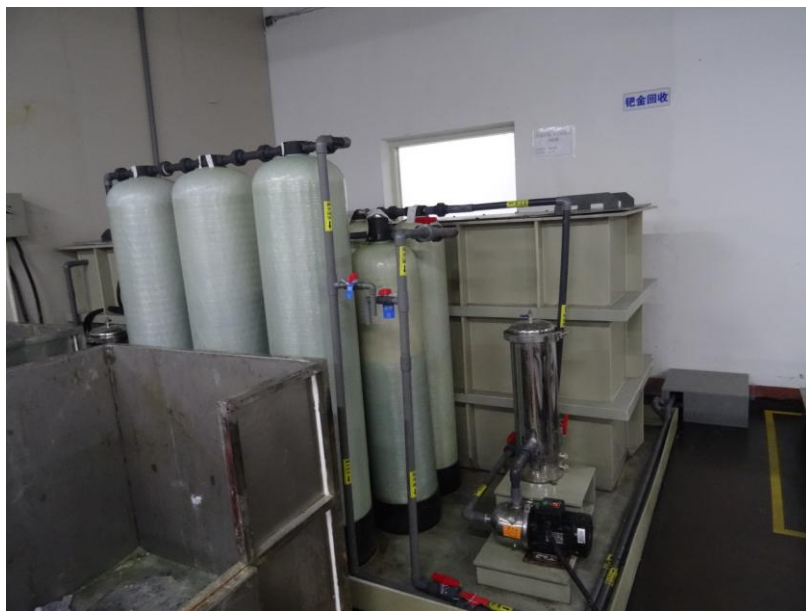
含氰、含钯废水预处理系统
