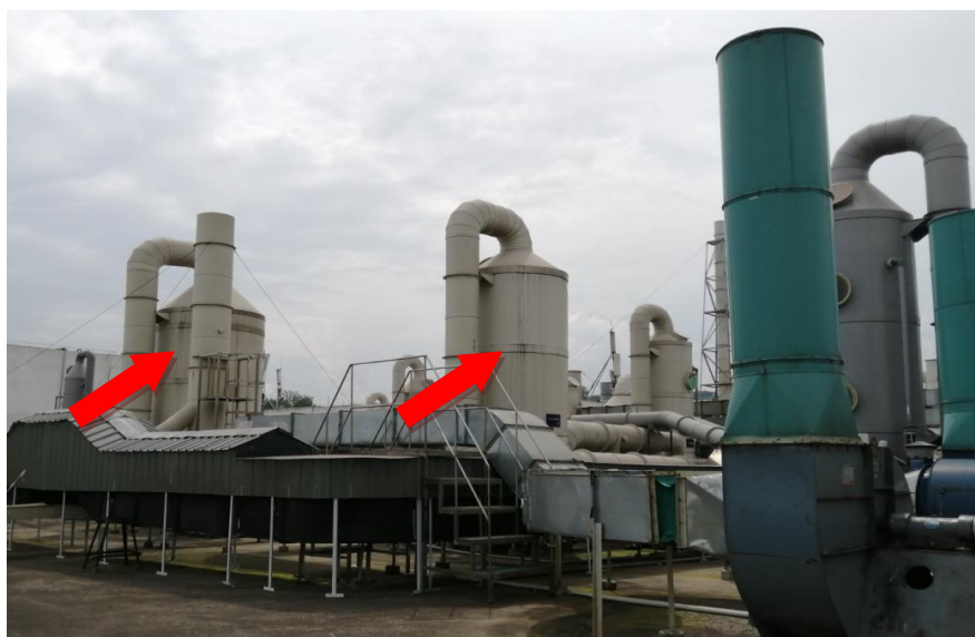
电镀铜酸性废气碱性喷淋处理设施
