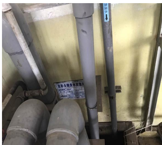
显影去膜废水应急池
