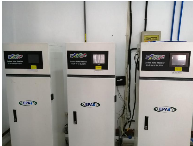
生产废水总排口在线监测设施
