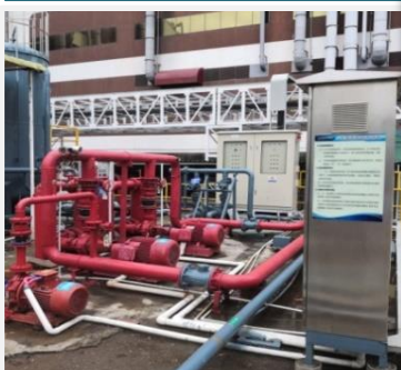
消防水泵房(改善後)
